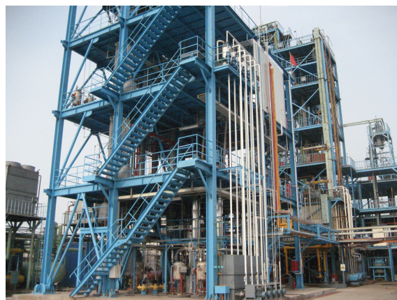
离子膜用功能单体、中间体工程装置
