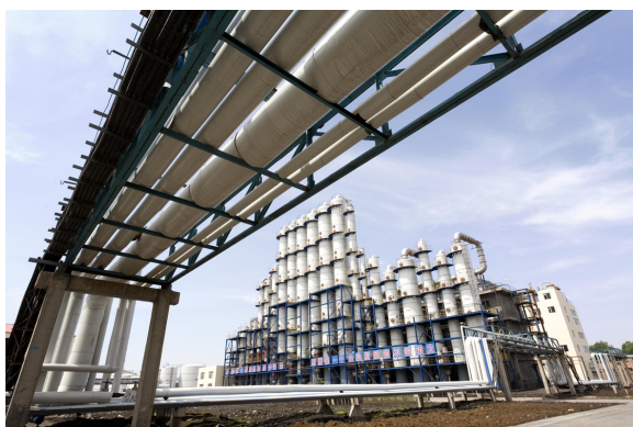
国际首创的 20 万吨玉米化工醇大规模产业化 生产线实景
